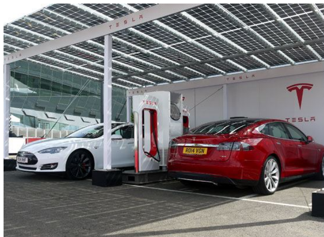
Рис. 13. Зарядна фотоелектрична станція електротранспорту Tesla (США).
